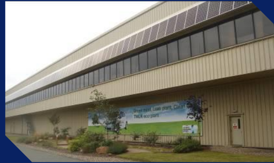
26 kWp Brise Soleil 26KWpブリーズ・ソレイユ
